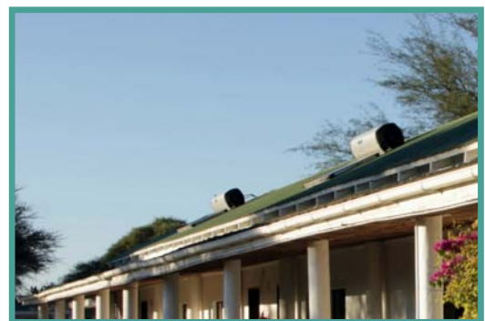
Thermische Solaranlage auf einem Dach in Botswana
